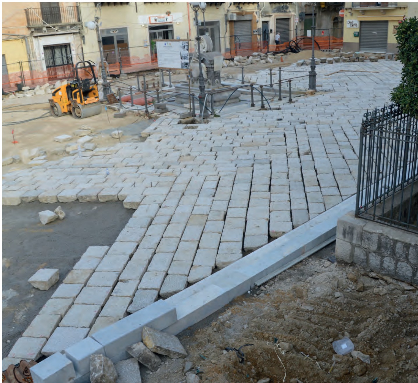
Fig. 26 - La foto evidenzia la mancata cura per i dettagli; è totalmente impropria la finitura superficiale che doveva essere finalizzata a migliorare l'aderenza al calpestio. Risulta ostile all'uso, perché irregolare e non sufficientemente levigata a tale azione..
