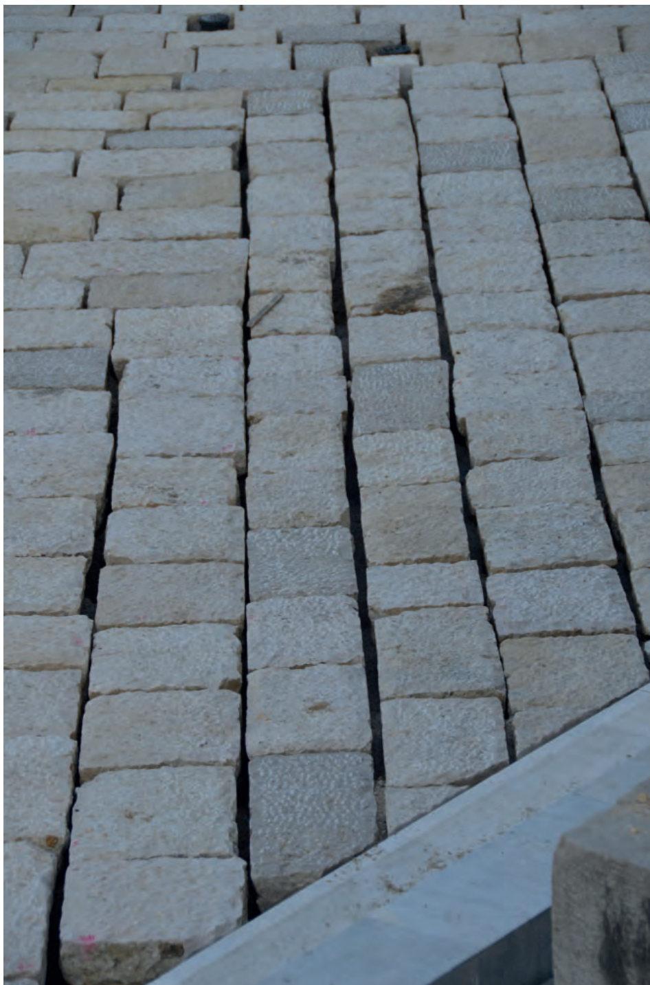
Fig. 29 - La foto evidenzia più particolareggiatamente la mancata cura per i dettagli; è totalmente impropria la finitura superficiale che doveva essere finalizzata a migliorare l'aderenza al calpestio. Risulta ostile all'uso, perché irregolare e non sufficientemente levigata a tale azione..
