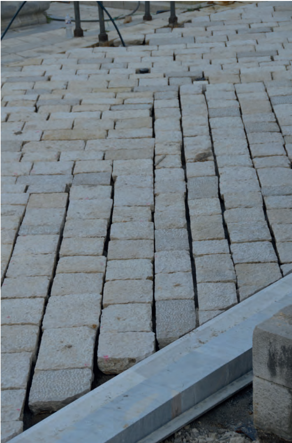
Fig. 30 - Nel nuovo ordito del basolato si nota la mancata cura per i dettagli che richiede un'opera di tale entità, inoltre, è totalmente impropria la finitura superficiale che andava finalizzata a migliorare l'aderenza al calpestio. Risulta ostile all'uso, in quanto irregolare e non sufficientemente levigata a tale azione.
