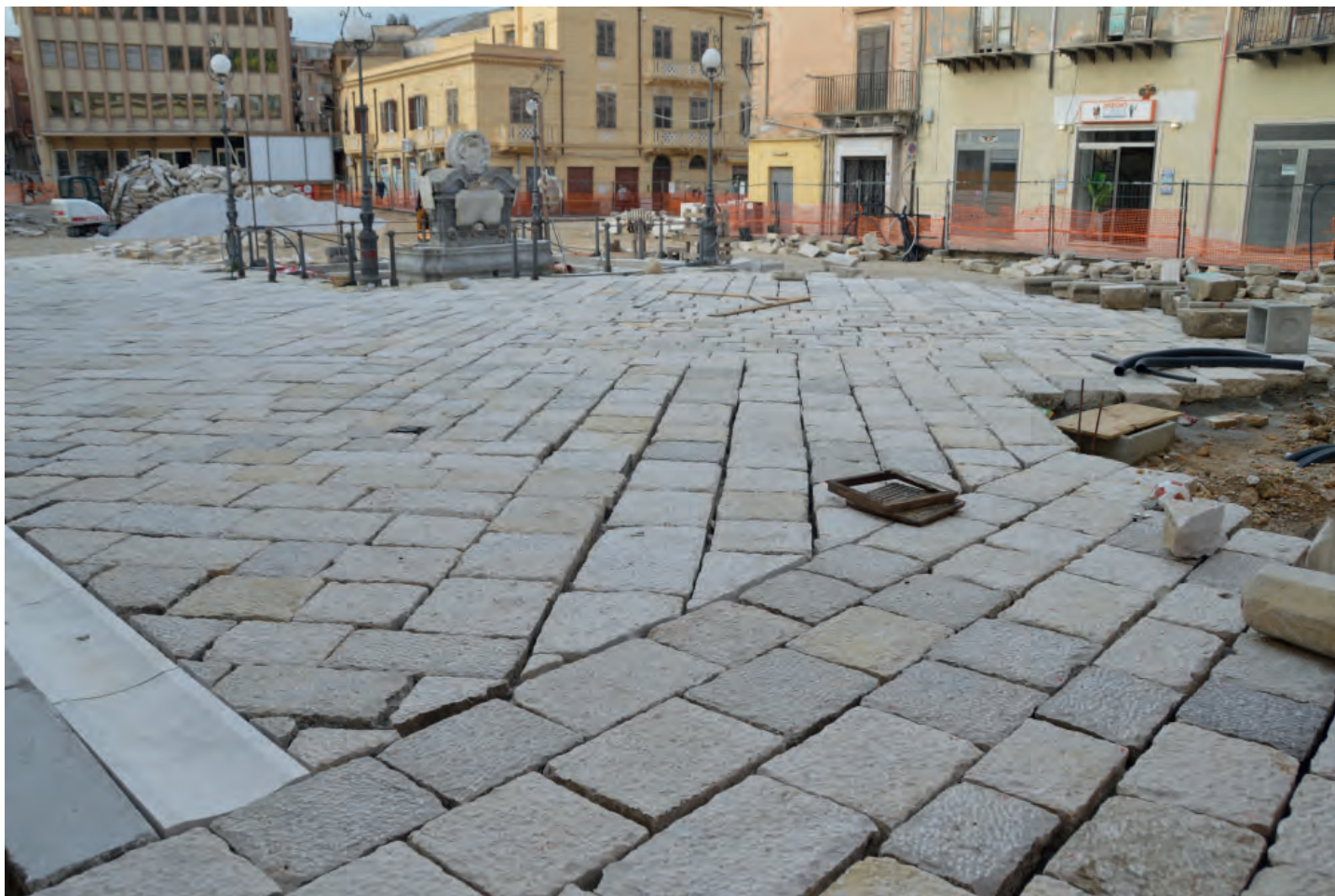
Fig. 21 - La foto evidenzia la mancata cura per i dettagli; è totalmente impropria la finitura superficiale che doveva essere finalizzata a migliorare l'aderenza al calpestio. Risulta ostile all'uso, perché irregolare e non sufficientemente levigata a tale azione..
