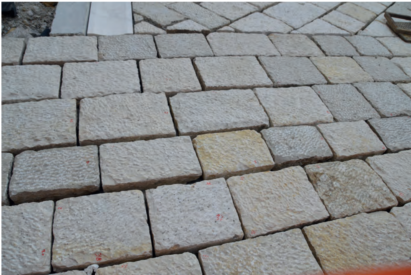
Fig. 23 - La foto evidenzia la mancata cura per i dettagli; è totalmente impropria la finitura superficiale che doveva essere finalizzata a migliorare l'aderenza al calpestio. Risulta ostile all'uso, perché irregolare e non sufficientemente levigata a tale azione..
