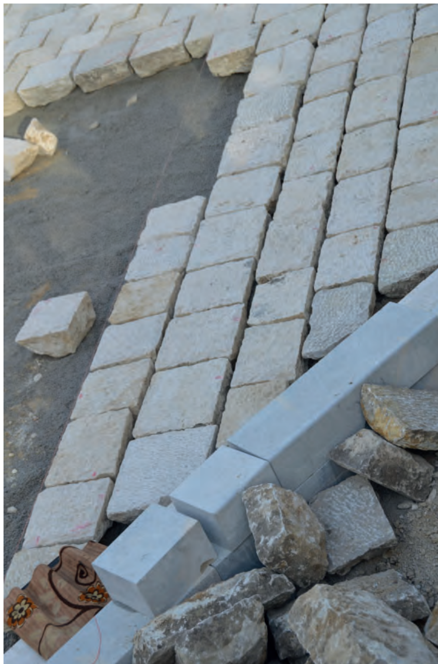
Fig. 28 - La foto evidenzia la mancata cura per i dettagli; è totalmente impropria la finitura superficiale che doveva essere finalizzata a migliorare l'aderenza al calpestio. Risulta ostile all'uso, perché irregolare e non sufficientemente levigata a tale azione.
