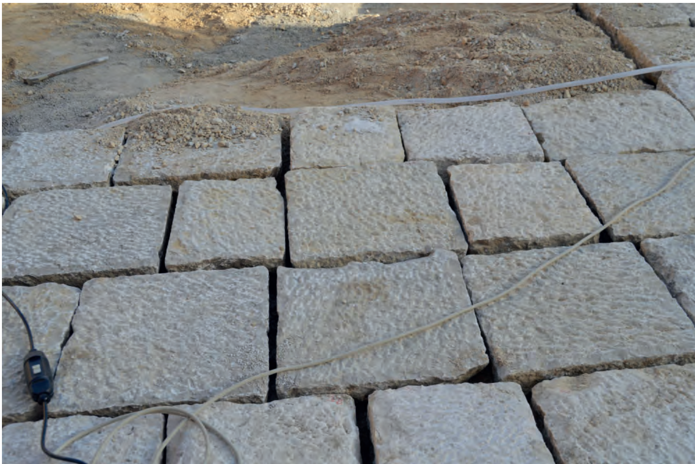
Fig. 20 - La foto evidenzia la mancata cura per i dettagli; è totalmente impropria la finitura superficiale che doveva essere finalizzata a migliorare l'aderenza al calpestio. Risulta ostile all'uso, perché irregolare e non sufficientemente levigata a tale azione..
