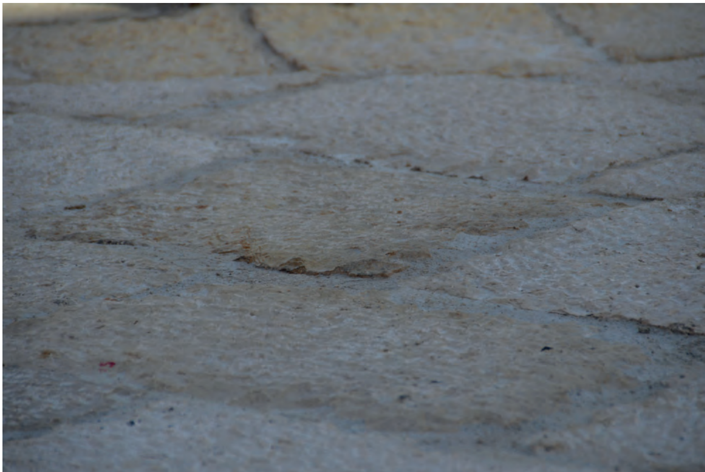
Fig. 11 - Foto del nuovo basolato che documenta la errata posa che genera superfici non complanari, spesso con spigoli e sporgenze, che rendono la superficie di dubbia funzionalità..
