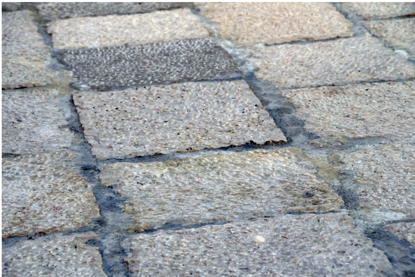
Fig. 14 - Foto del nuovo basolato che documenta la errata posa che genera superfici non complanari, spesso con spigoli e sporgenze, che rendono la superficie di dubbia funzionalità.
