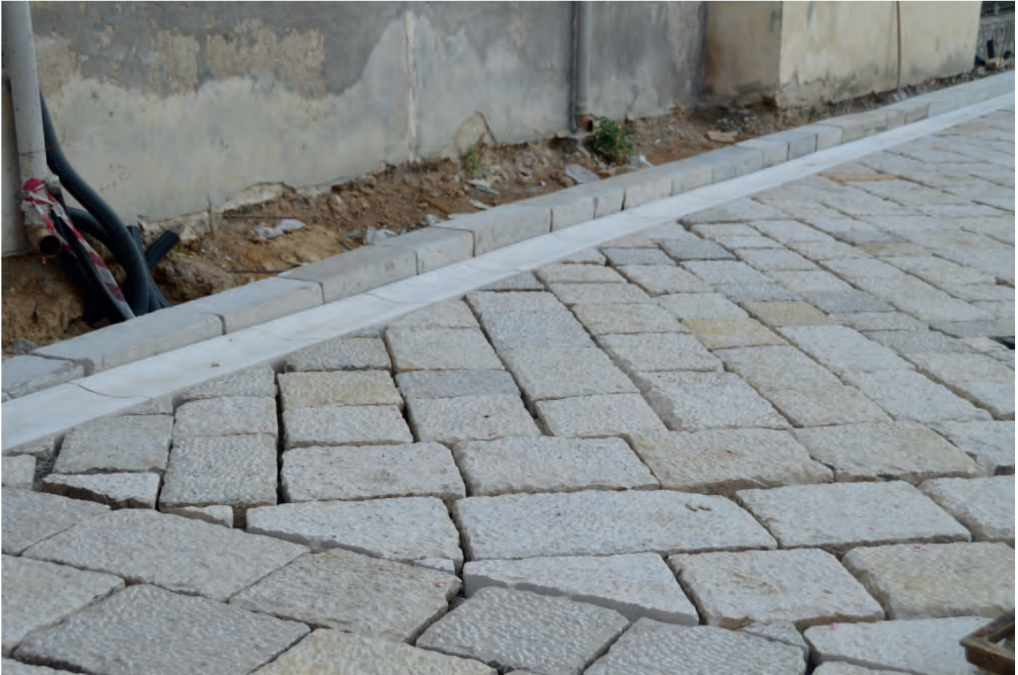
Fig. 22 - La foto evidenzia la mancata cura per i dettagli; è totalmente impropria la finitura superficiale che doveva essere finalizzata a migliorare l'aderenza al calpestio. Risulta ostile all'uso, perché irregolare e non sufficientemente levigata a tale azione..
