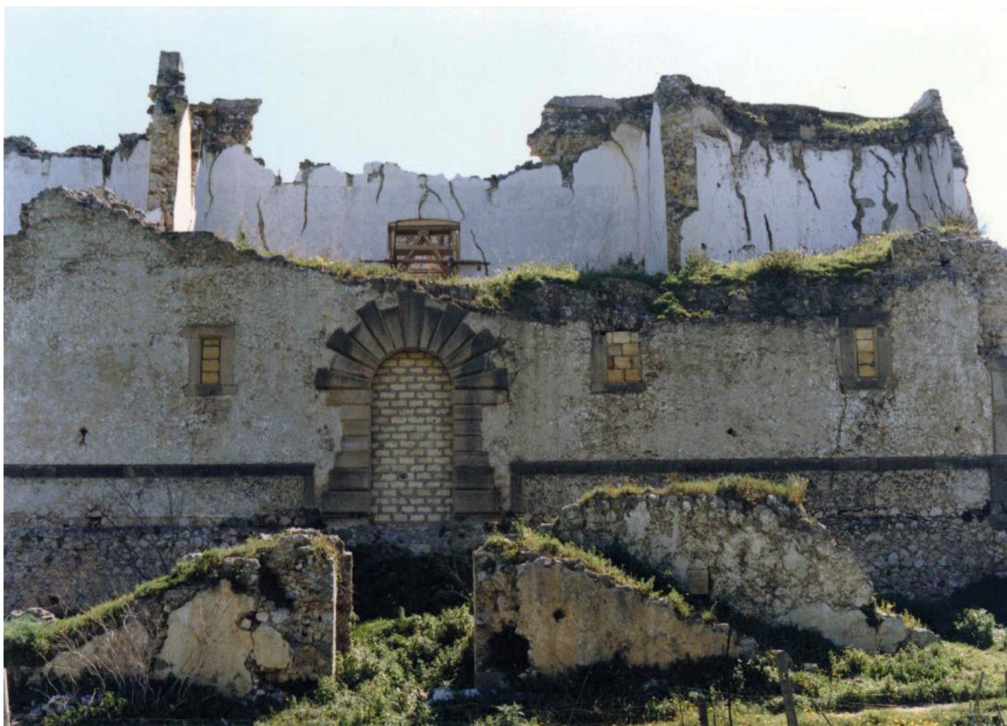
Fig. 20 - Le condizioni in cui si trovava il Palazzo prima del restauro
