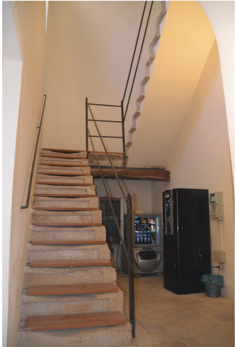
Fig. 37 - Le due rampe della scala in pietra monoblocco. La seconda rampa è stata intonacata
