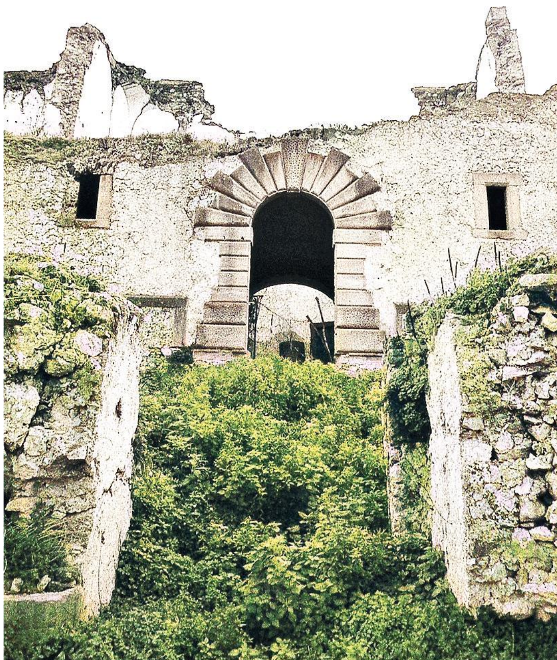
Fig. 28 - Il Palazzo Ram: le condizioni di degrado dopo il crollo del sistema di accesso. La foto mostra che la porta d'ingresso al palazzo era posta su un piano sopraelevato (foto Toti Vescovo)
