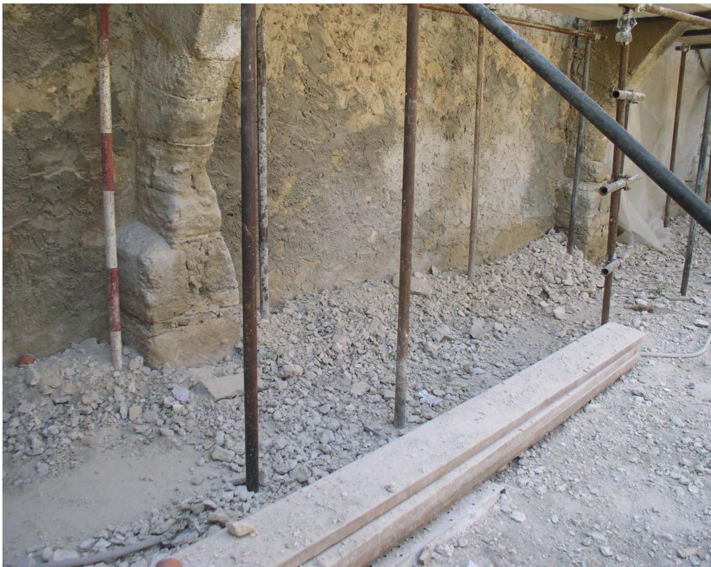
Fig. 49 - La parete del loggiato in cui era stato rinvenuto l'affresco, nel momento in cui venne completamente ripulita dall'intonaco
