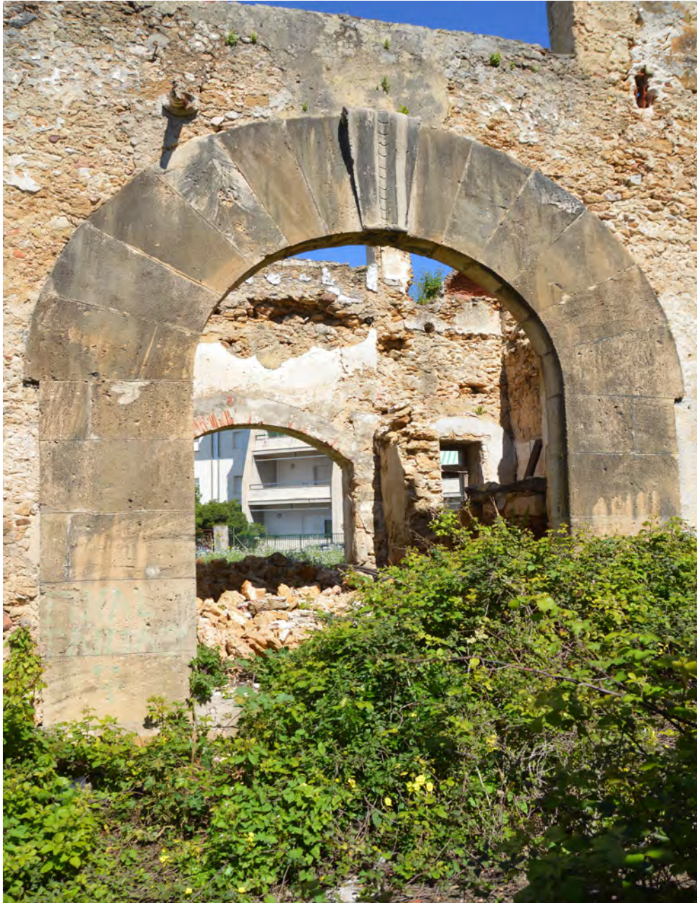
Fig. 21 - Il portale ormai sopraffatto dai rovi
