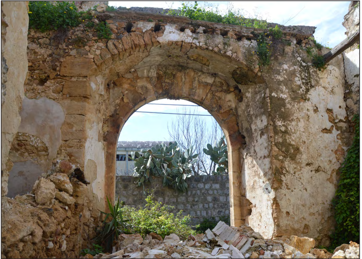
Fig. 23 - L'androne ormai crollato
